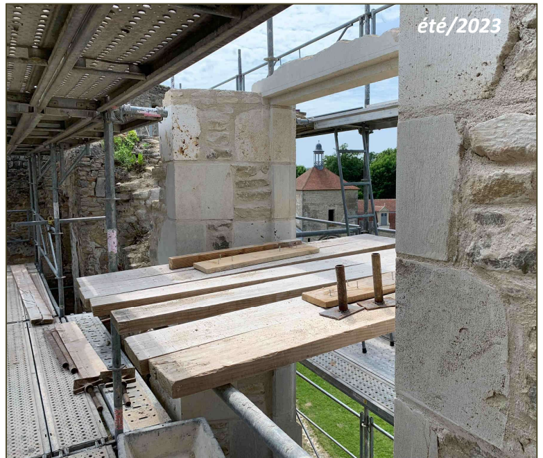
baie du 2ème étage donnant sur cour (avant à gauche, et après à droite)
